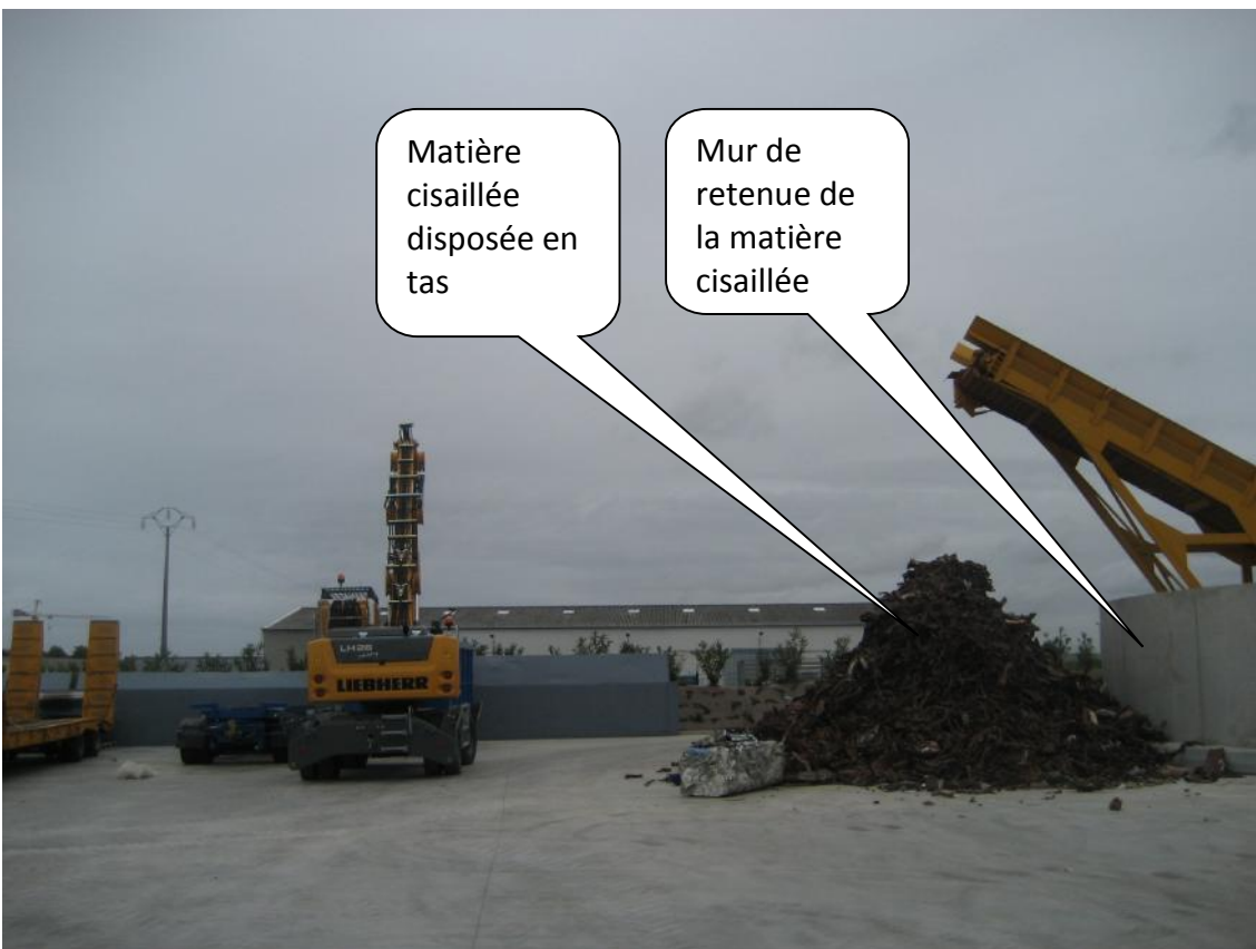
Photo de l'installation du site de Migné-Auxances (86440)
