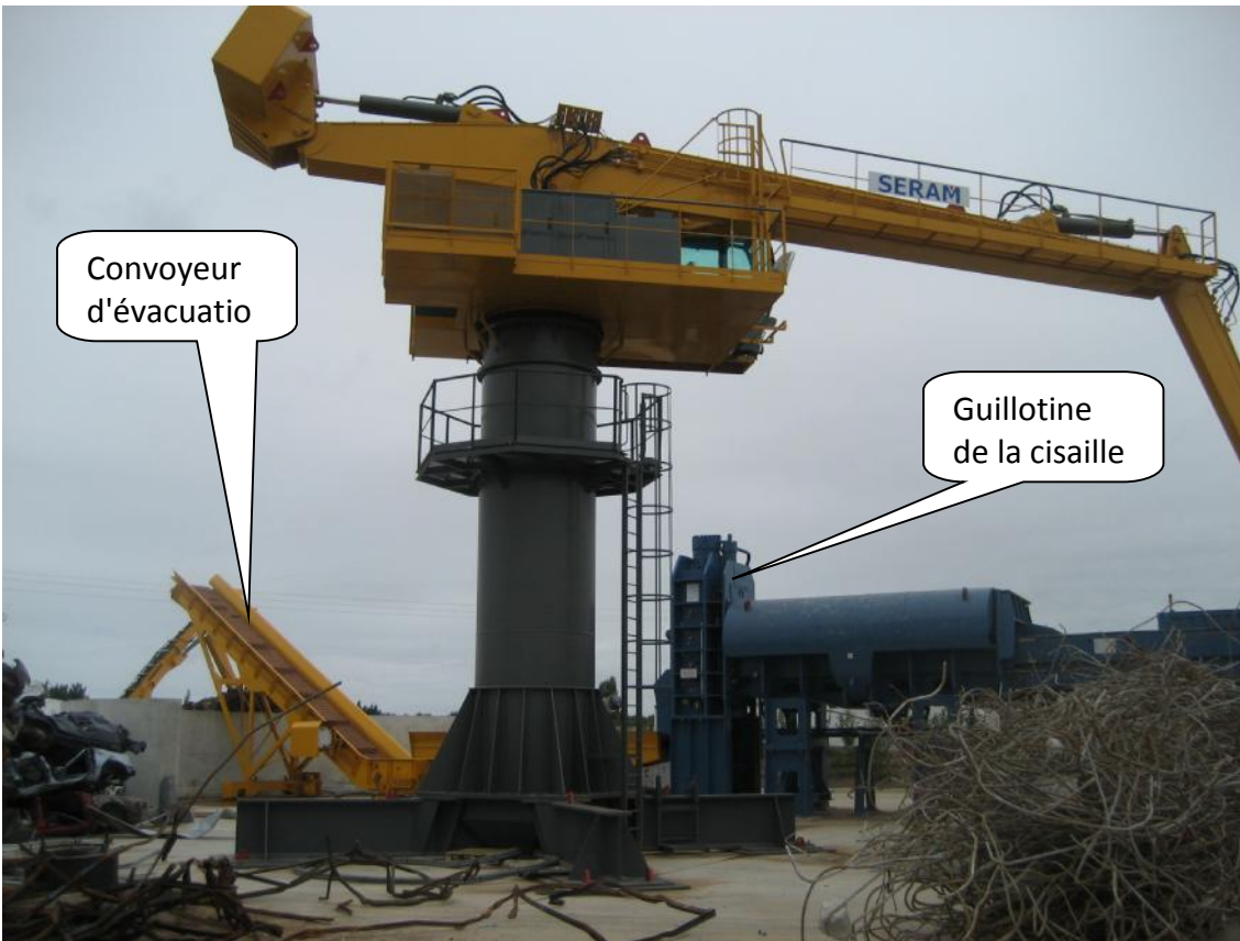
Photo de l'installation du site de Migné-Auxances (86440)
